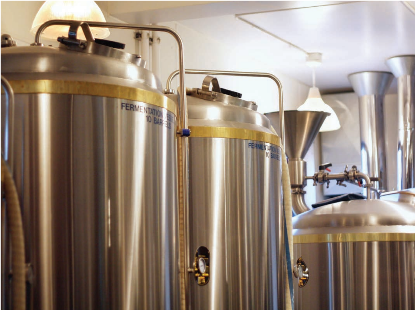
Panimot käyttävät DOWCAL™ N -nesteitä käymis- ja vierresäiliöiden lämpötilan säätelyyn.
